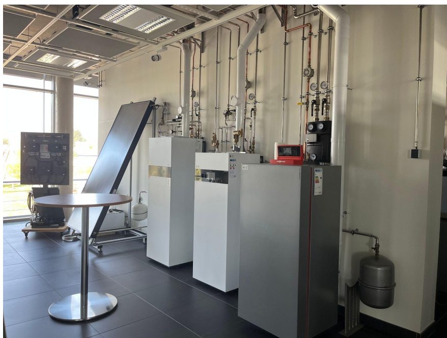
Vue 2 : Vues intérieures d'un centre de formation Viessmann
